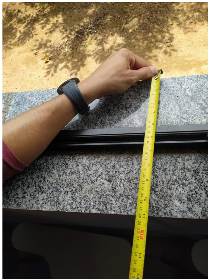
Imagem 01 – Existência de peitoris com 27,5 cm de largura no Bloco B do Câmpus Paraíso.
